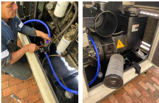
Mantenimiento preventivo planta eléctrica.
